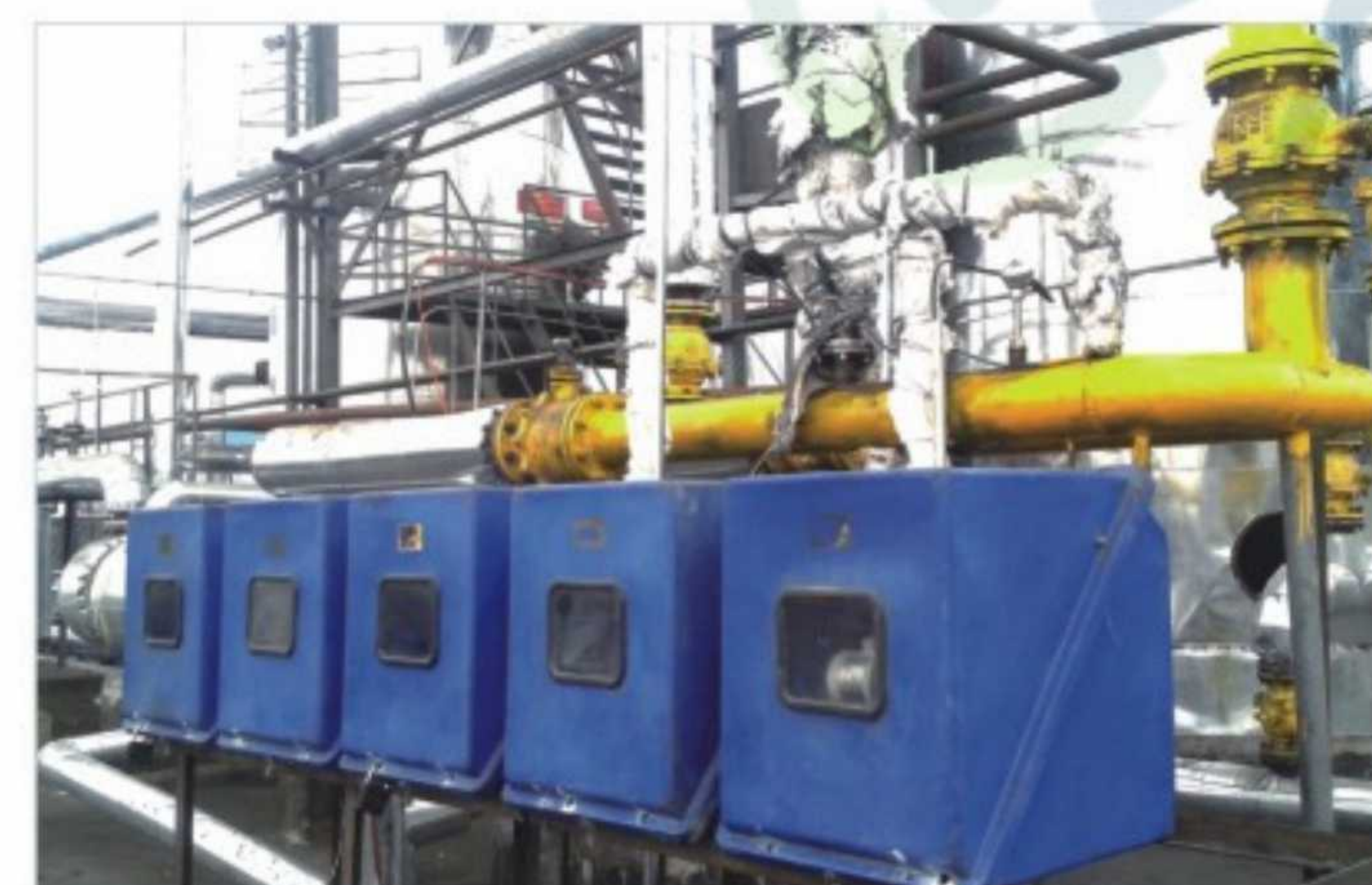
新疆喀什德力克石油工程技术有限公司 介质：天然气（含水、含硫、含石蜡、两相流贸易计量） 管外径×壁厚：φ168×4mm 压力：1.6MPa 温度：35℃
