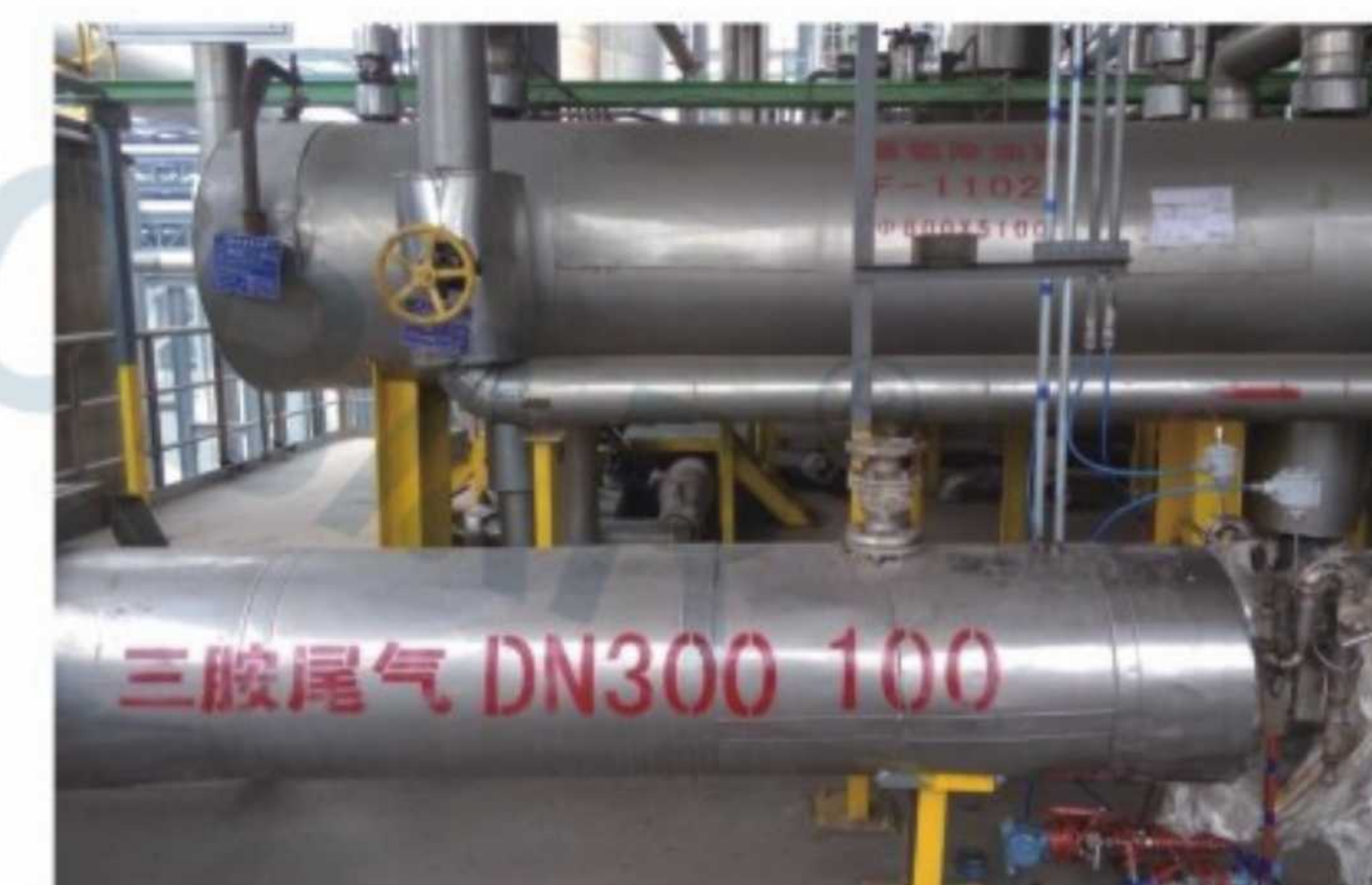
山东鲁西化工集团 介质：三胺尾气 管外径×壁厚：φ325×8mm 压力：0.8MPa 温度：130℃
