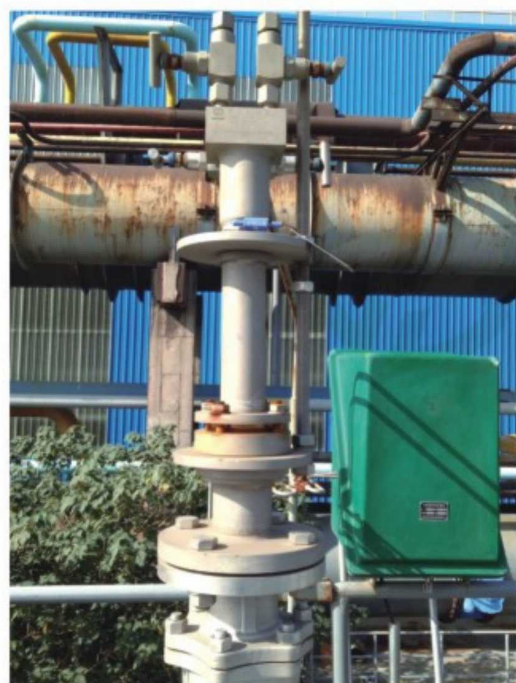
马鞍山钢铁股份有限公司 介质：高焦混合煤气 管外径×壁厚：φ720×6mm 压力：0.1MPa 温度：50℃
