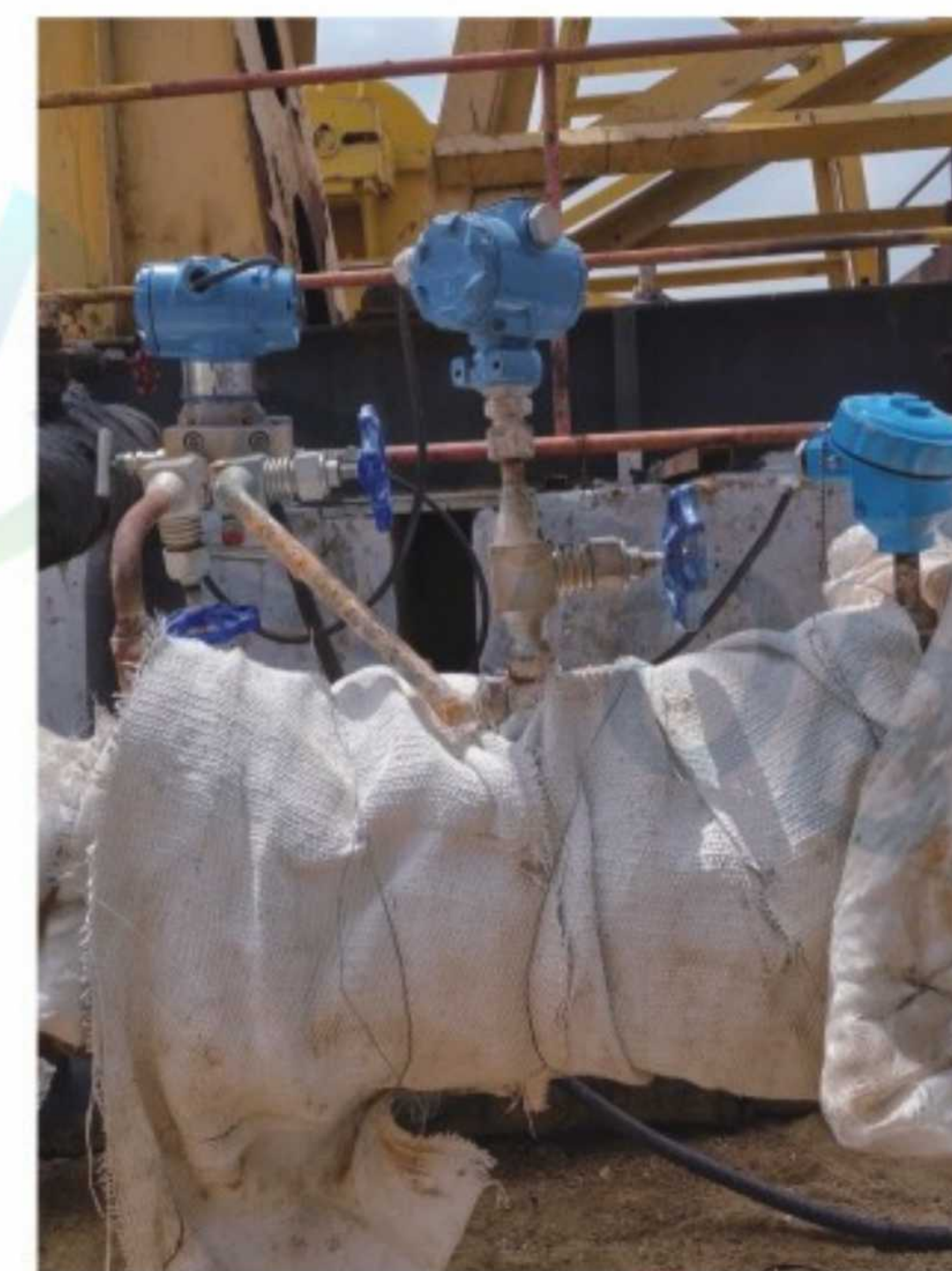
盘锦辽河油田 介质：湿蒸汽 管径：DN50 管道压力：8MPa 温度：350℃ 刻度流量：7t/h
