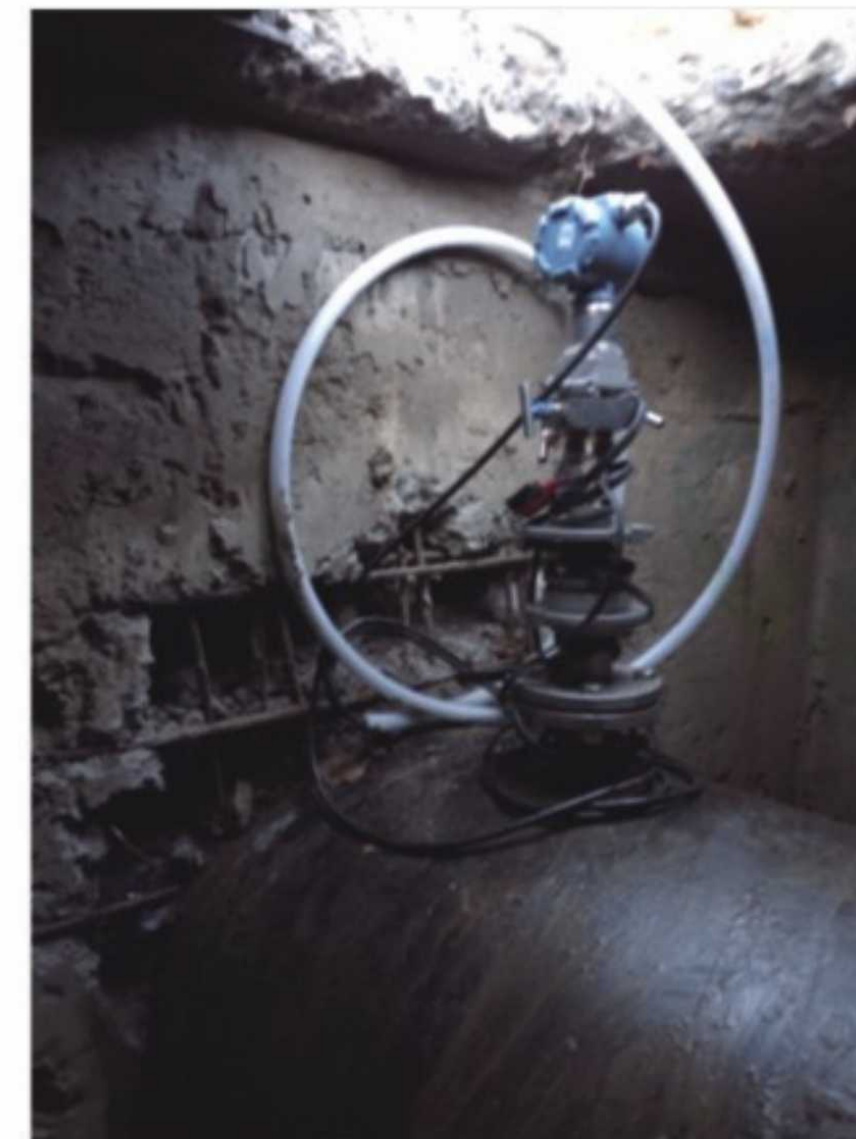
铁岭财京公用事业有限公司 介质: 含气泡水 管外径×壁厚: \phi 920 \times 10 \text{ mm} 压力: 0.2MPa 温度: 常温
