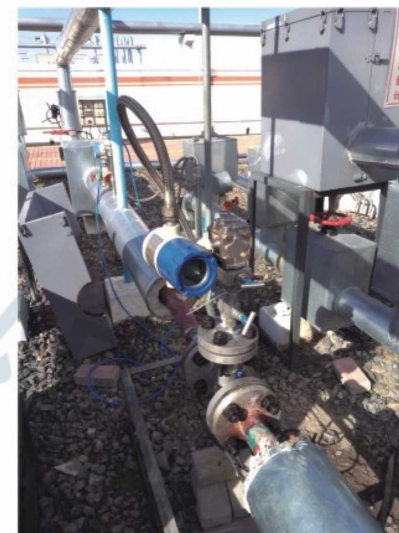
大庆油田采气分公司 介质：含水天然气（湿气） 管径：DN50 管道压力：5MPa 温度：30℃ 刻度流量：5000Nm 3 /h
