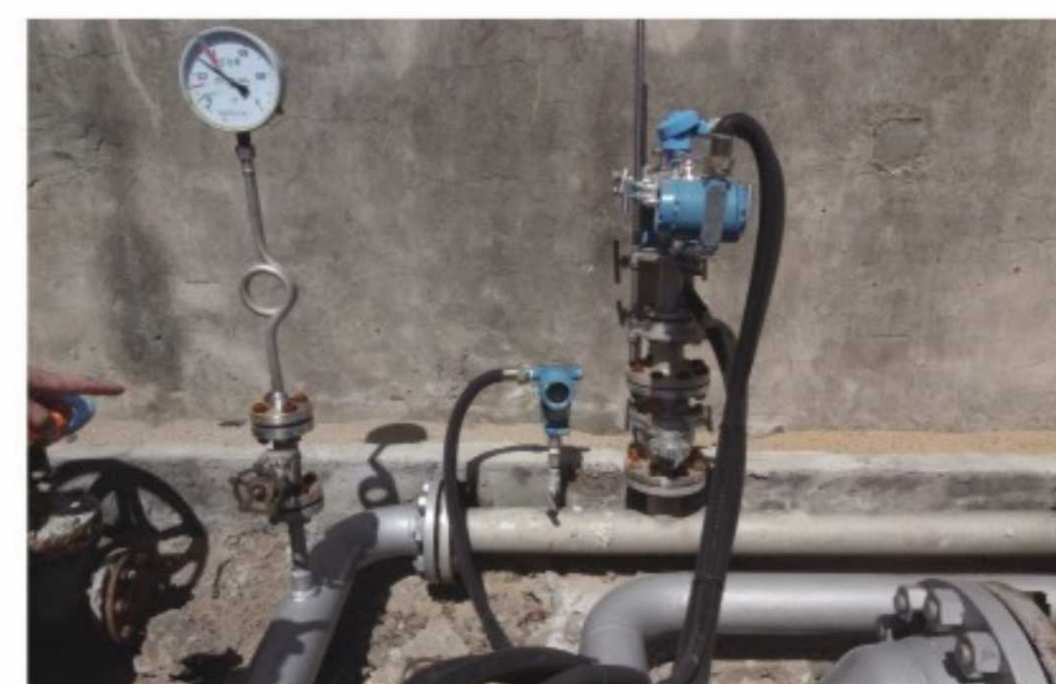
中国石油化工股份有限公司镇海炼化分公司 介质：丙烷气 管外径×壁厚：φ273×7mm 压力：0.5MPa 温度：80℃
