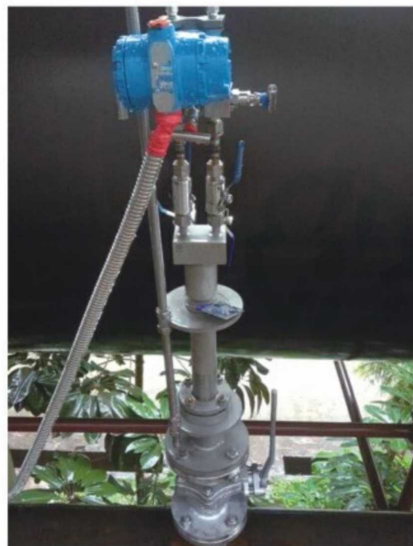
宝武集团广东韶关钢铁有限公司 介质：焦炉煤气 管外径×壁厚：φ273×6mm 压力：0.6MPa 温度：常温
