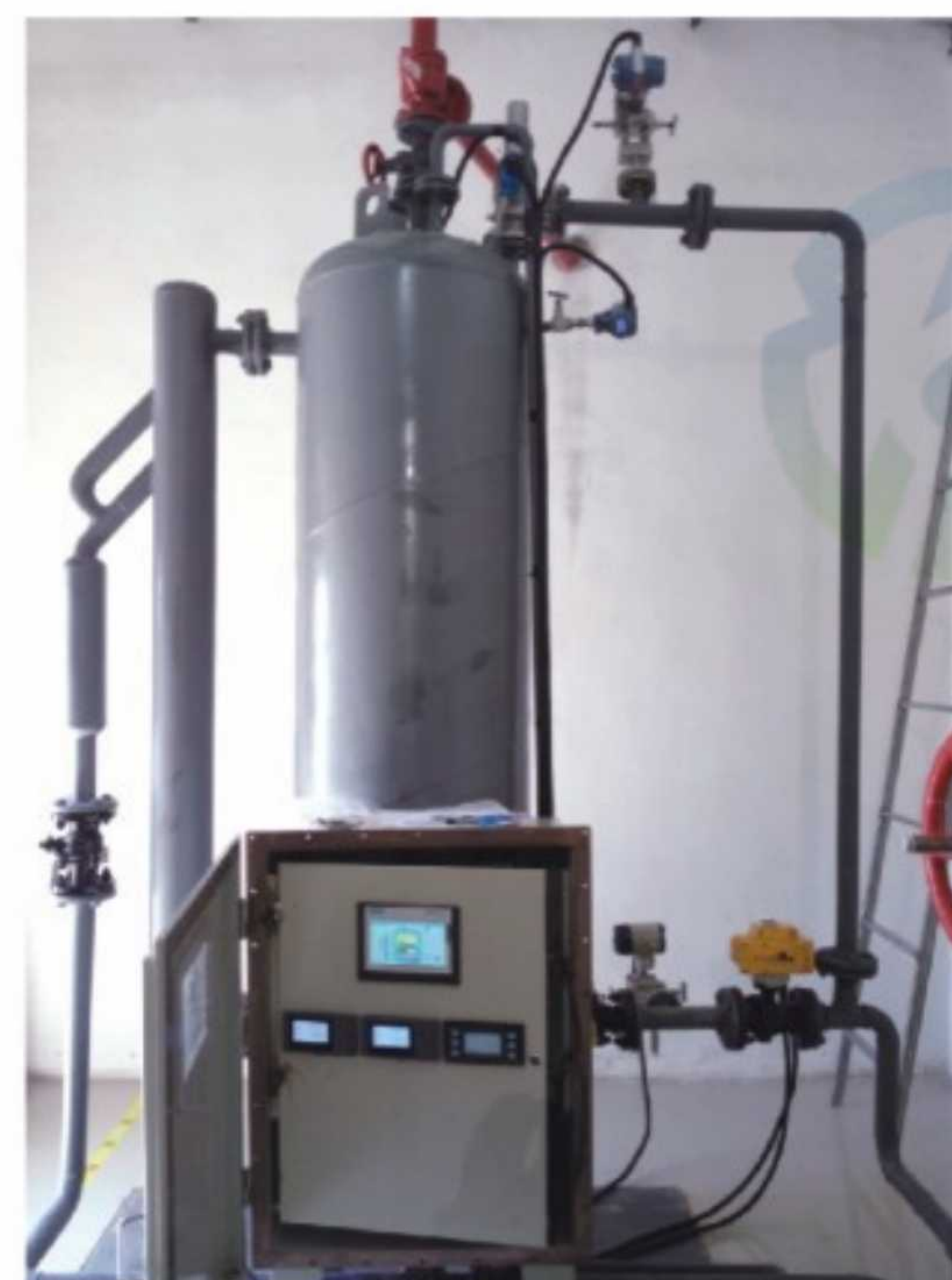
大庆采油五厂 第一油矿九区三队131计量间 毕托巴® 三相流智能计量撬对 计量间内各油井产液量实施定 期检测，及时掌握各井产能情况
