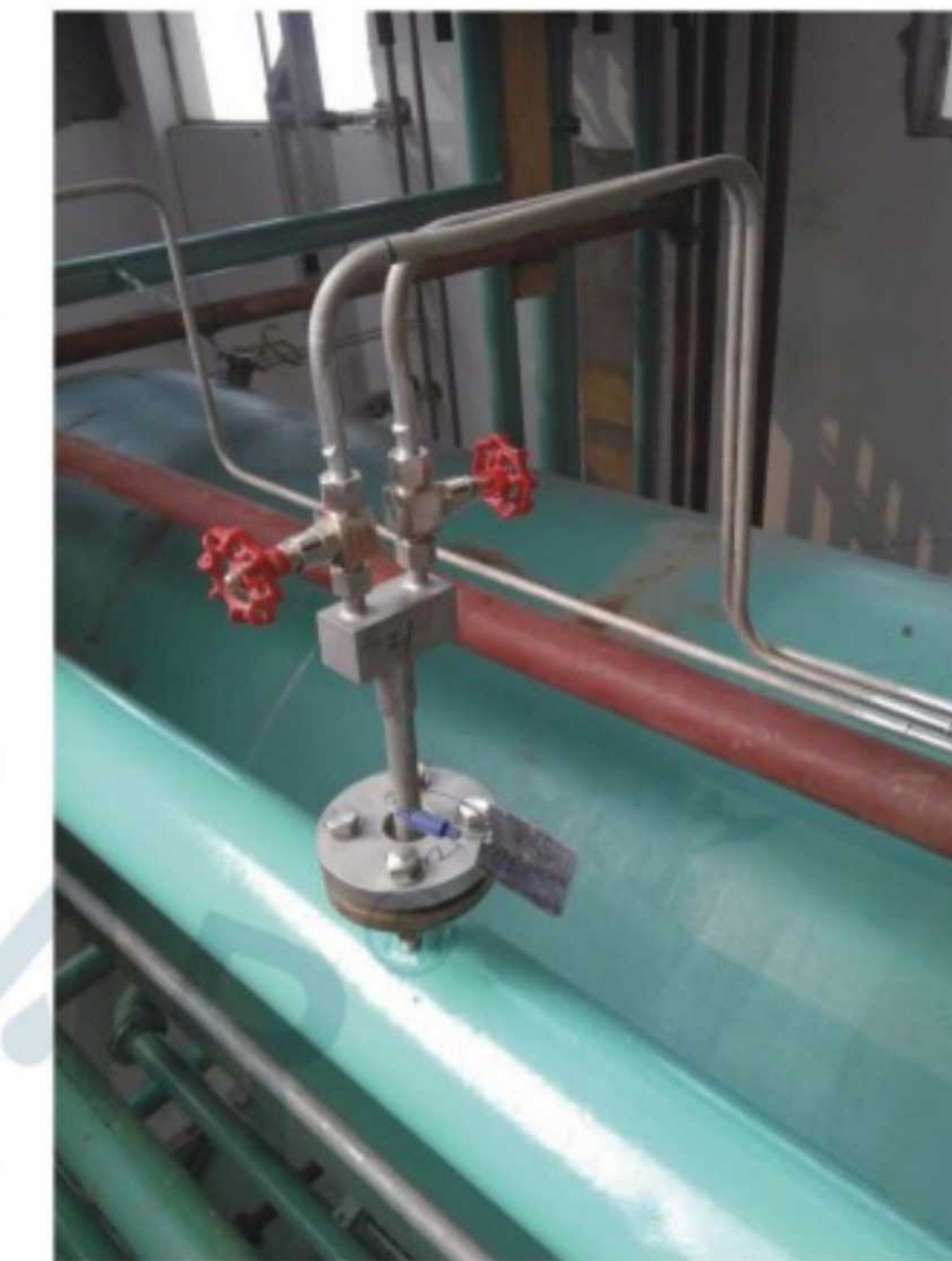
江西安源电厂 介质: 除盐水 管外径×壁厚: \phi 89 \times 4.5 \text{ mm} 压力: 0.7MPa 温度: 常温
