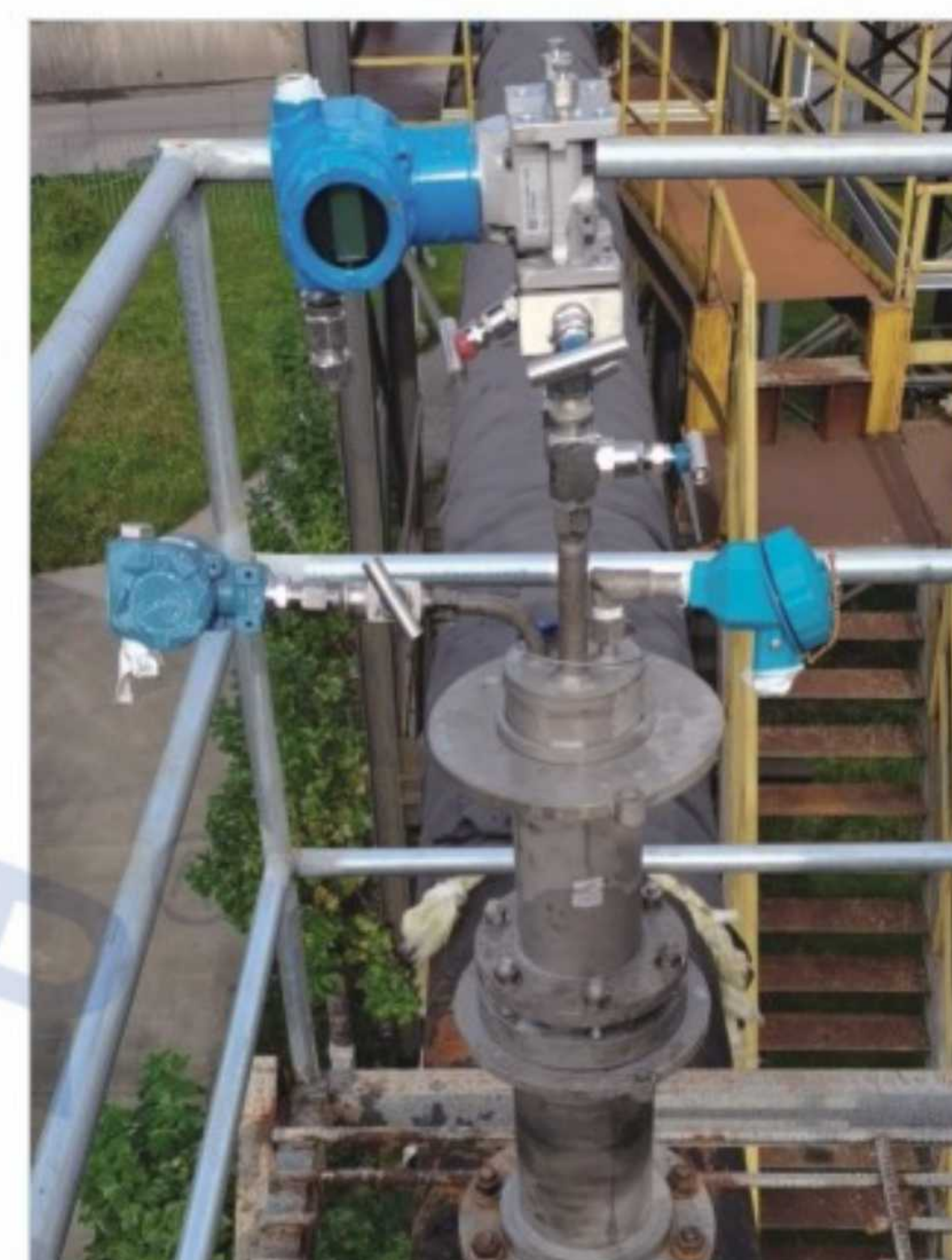
黑龙江双鸭山建龙钢铁有限公司 介质：焦炉煤气 管外径×壁厚：φ426×13mm 压力：8kPa 温度：30℃
