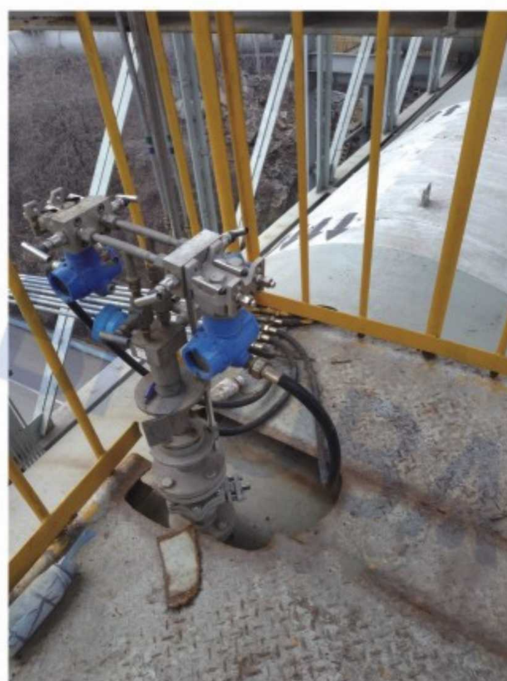
莱芜钢铁集团有限公司 介质：双向煤气 管外径×壁厚：φ3020×12mm 压力：10kPa 温度：30℃
