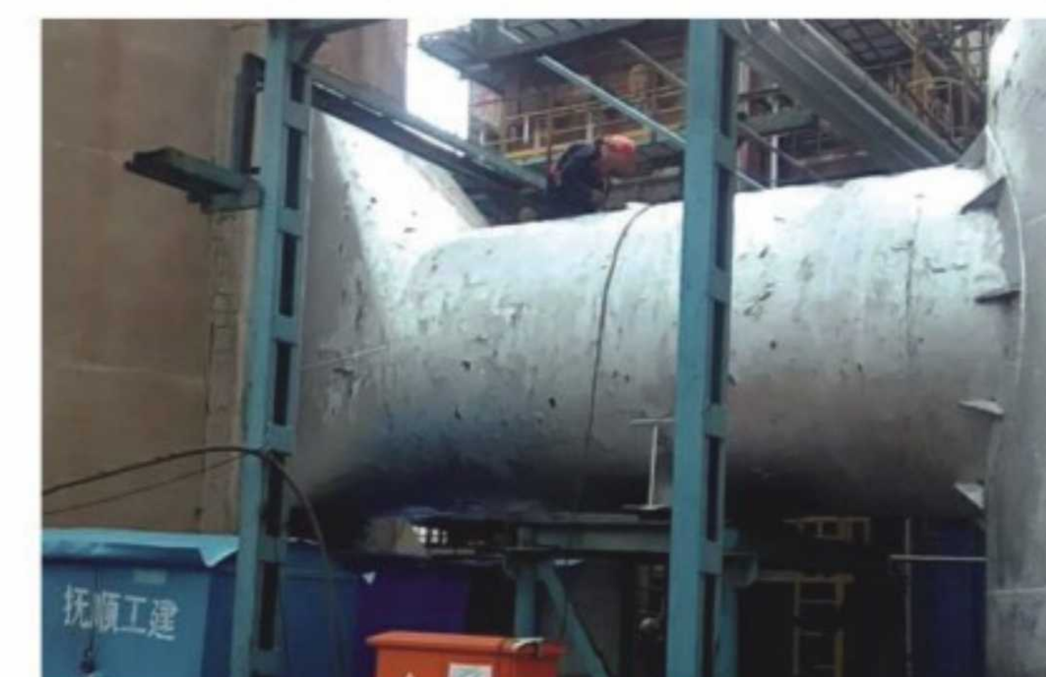
中国石油天然气股份有限公司抚顺石油二厂 介质：烟气 管外径×壁厚：φ2200×10mm 压力：0.009MPa 温度：400℃
