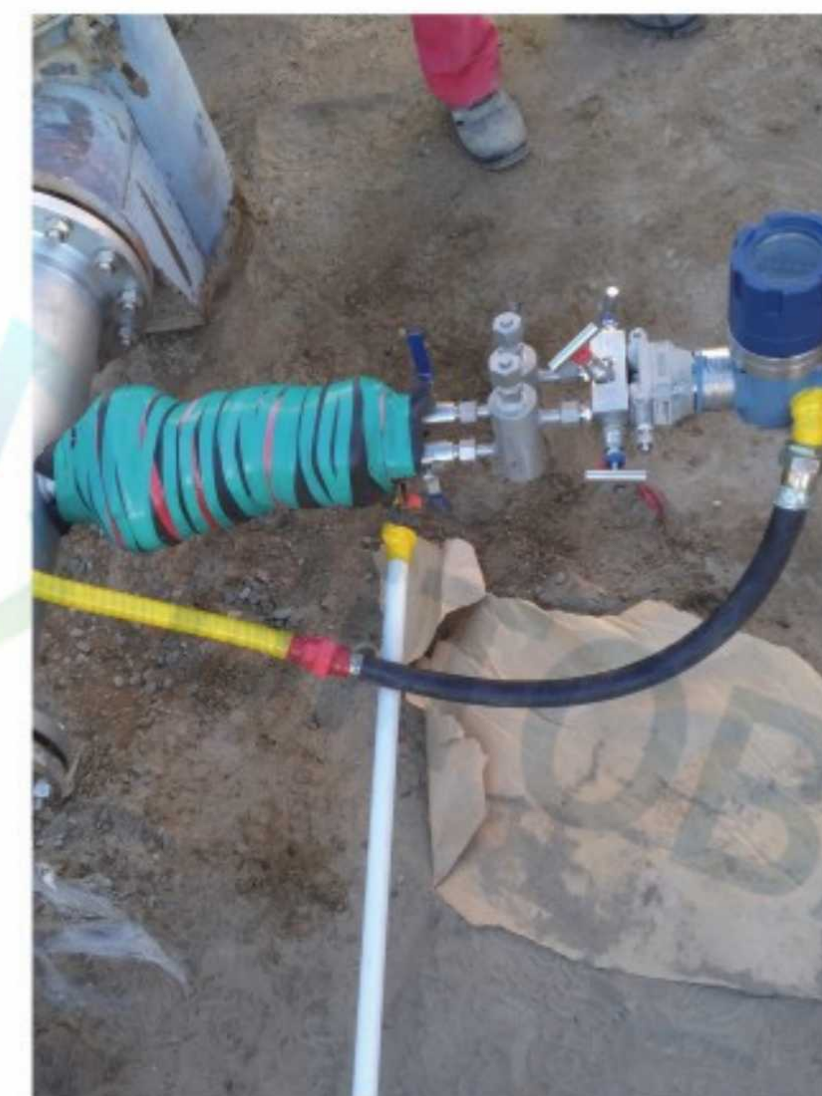
西北油田采油一厂 介质：含水原油 管径：DN200 管道压力：0.5 MPa 温度：50℃ 刻度流量：350 t/h
