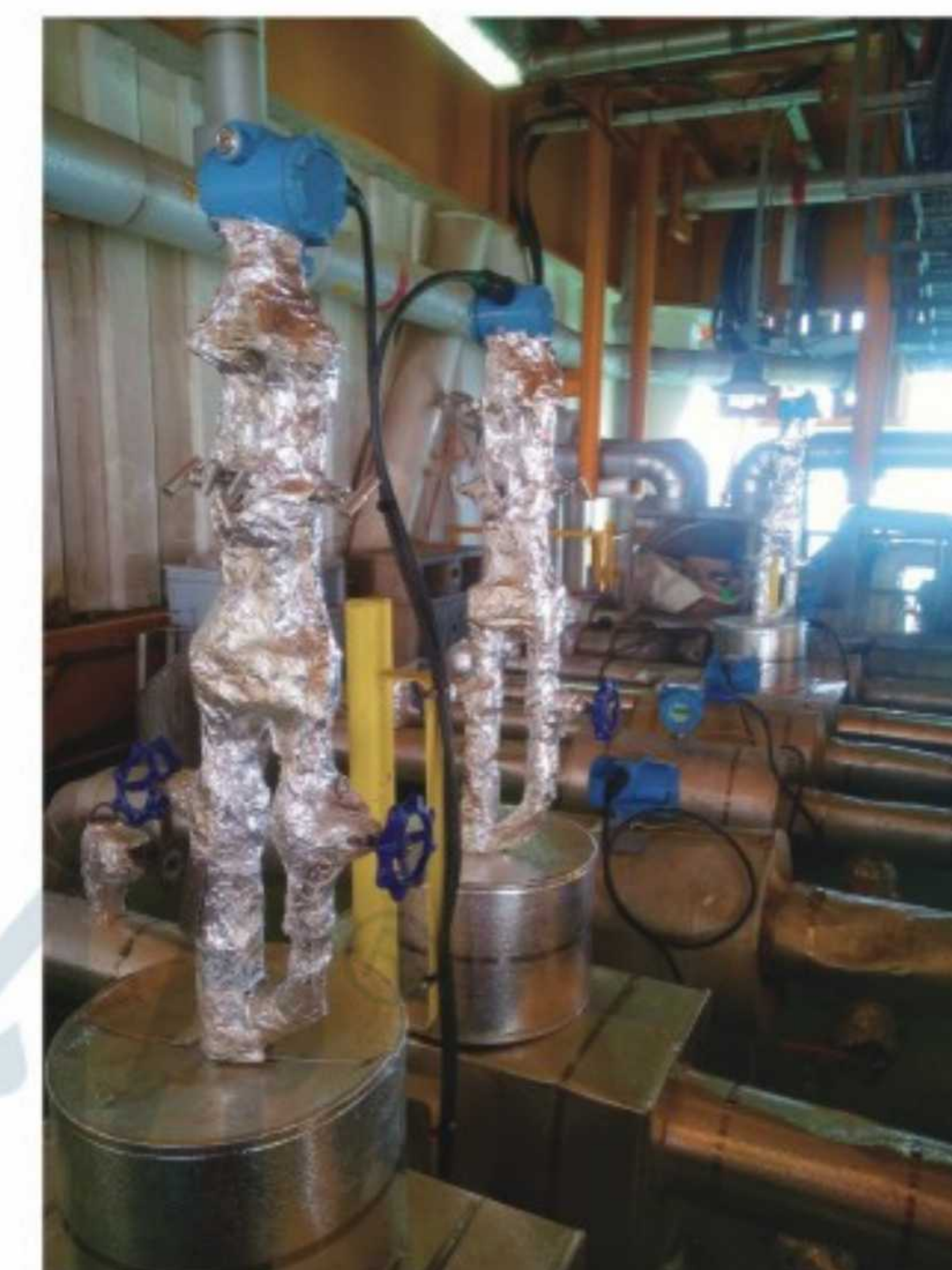
中海油KL3-2WHPA平台 介质：高温高压回注水， 管径：3英寸 管道压力：25 MPa 温度：80℃ 刻度流量：30m 3 /h
